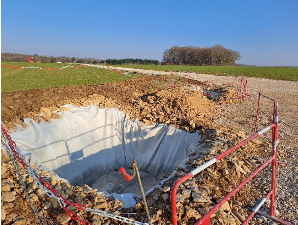
Exemple de fosse de lavage des toupies béton
